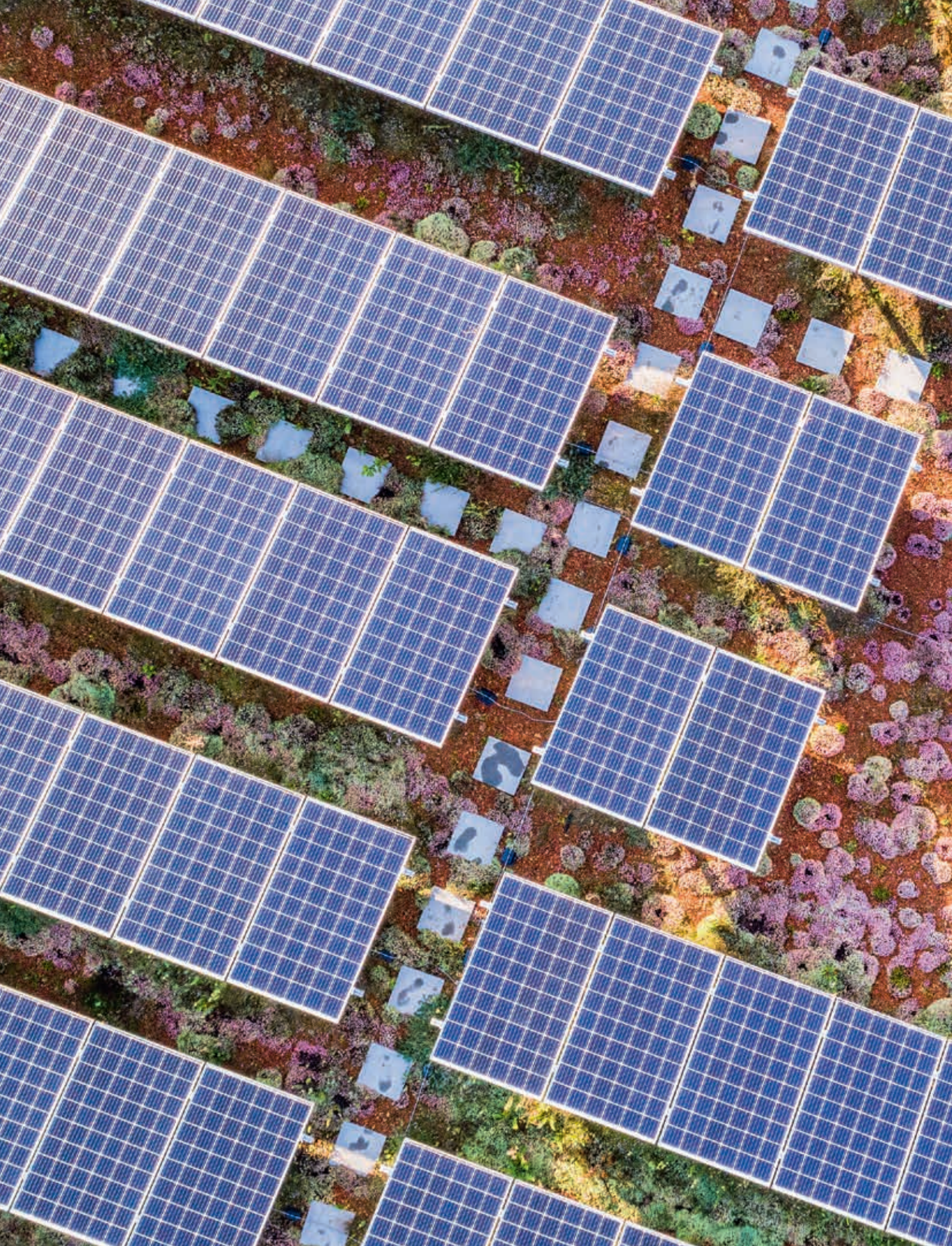
Das EnergieGrünDach von Contec beim OBI Schaffhausen Heimwerkermarkt.
