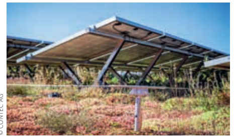
Contec.greenlight auf dem OBI Schaffhausen Dach.
